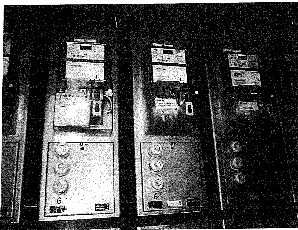
Elmätare i elcentralen.
